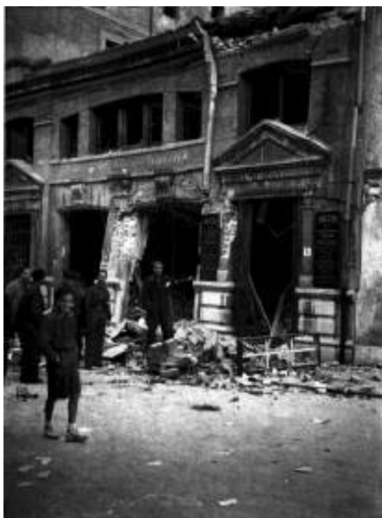
El edificio de LA VOZ DE ASTURIAS alcanzado por las bombas de la incursión vespertina republicana del 18 de septiembre. (Foto, Museo del Pueblo de Asturias, Gijón. Colección Constantino Suárez)
